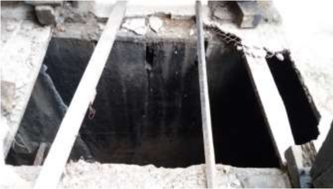
Imagen 51, poso ubicado en sala de máquinas, visita USACH 2019
