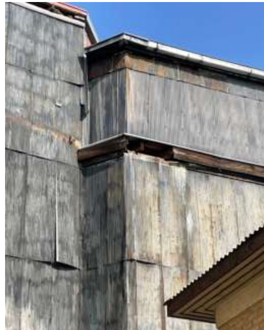
Imagen 49, mal estado de fachada por falta de mantención, MJL 2021
