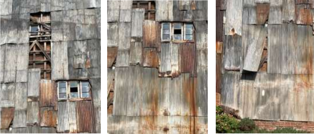
Imagen 47, estado revestimiento por fachada hacia calle Lecheros, conjunto habitacional de por medio
