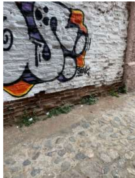
Imagen 46, desgaste base de albañilería, MJL 2021
